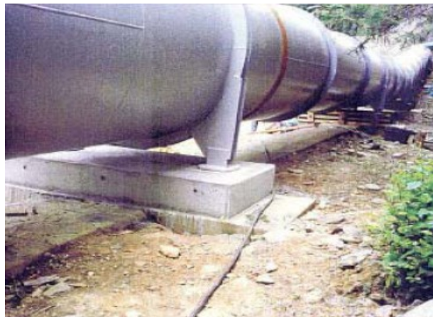
Photo 3 – exemple de conduite forcée aérienne, avec ses appuis sur des pilettes et ses ancrages
