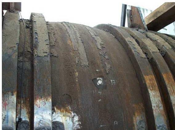
Photo 6 – cassure de frettes (conduite forcée de Pragnères)
